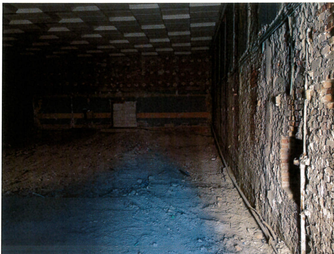
Zona sala spectacol – instalatii de apa dezafectate, paturi de cablu electrice nefunctionale
