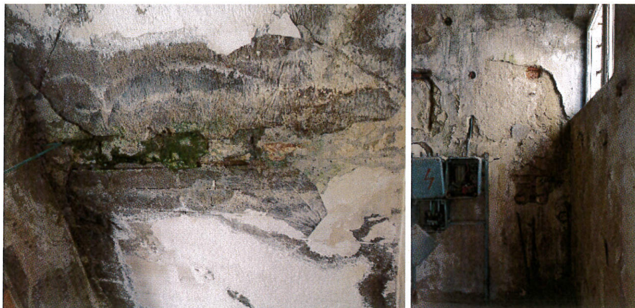
Zona statie ventilatie tvavan - degradari pereti
