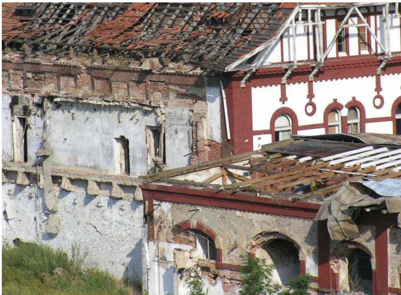
Foto 4. Deteriorari grave la sarcanta si fatada sudica
