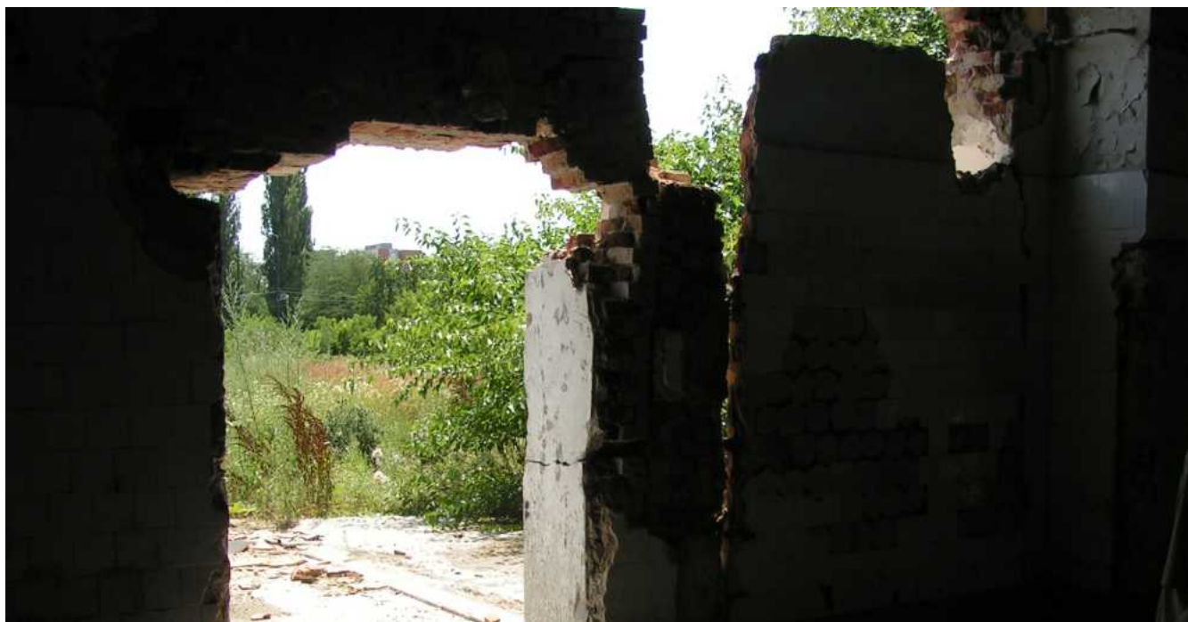
Foto 6. Deteriorari grave la peretii structurali ai halelor de sacrificare.
