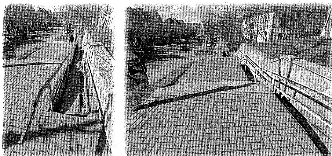
Figura nr. 38 Lipsa rampelor (Sursa : campanie de teren 18.03.2025)
