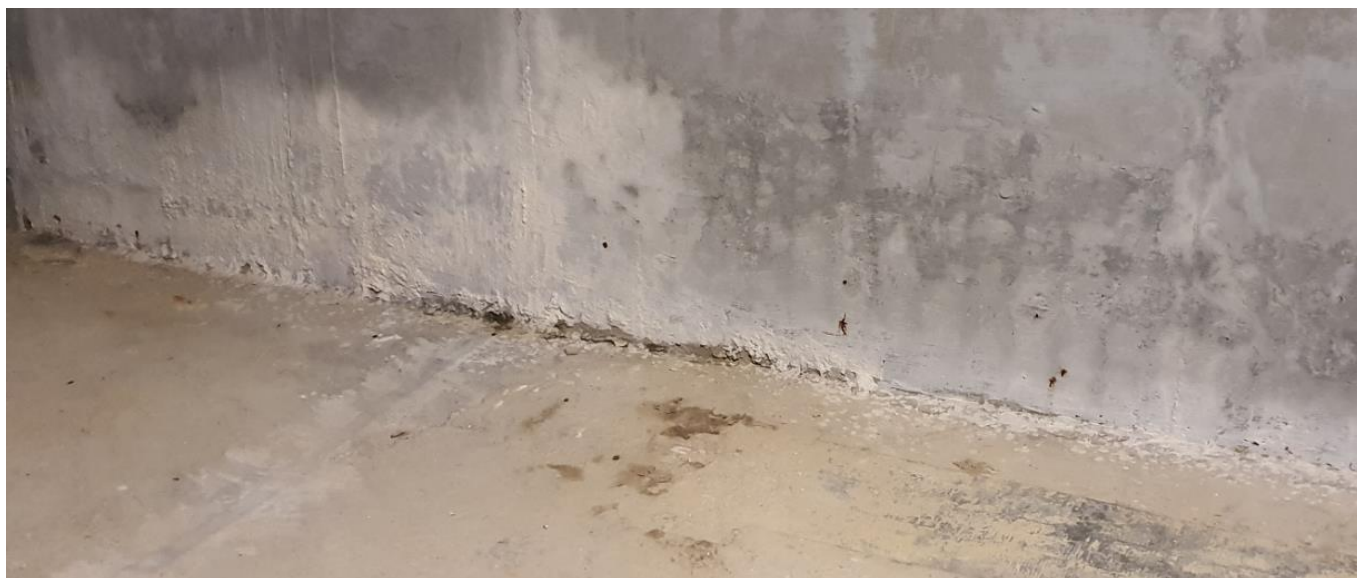
Fig. 8 – Infiltratii ale apei subterane prin rostul de turnare de la interfata peretelui perimetral cu radierul
