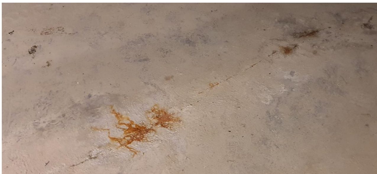
Fig. 6 – Fisura deschisa in radier cu infiltratii ale apei subterane si corodarea locala a armaturii
