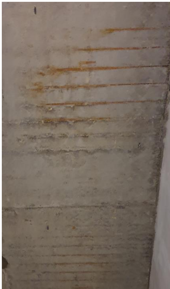
Fig. 12 – Corodarea incipienta a armaturilor de la partea inferioara a placii cauzata de acoperirea insuficienta a armaturilor
