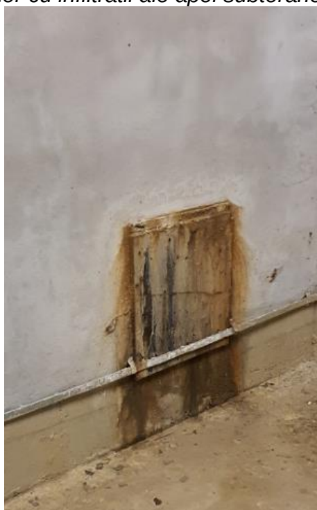
Fig. 7 – Infiltratii ale apei subterane in jurul golurilor tehnologice din peretii perimetrali
