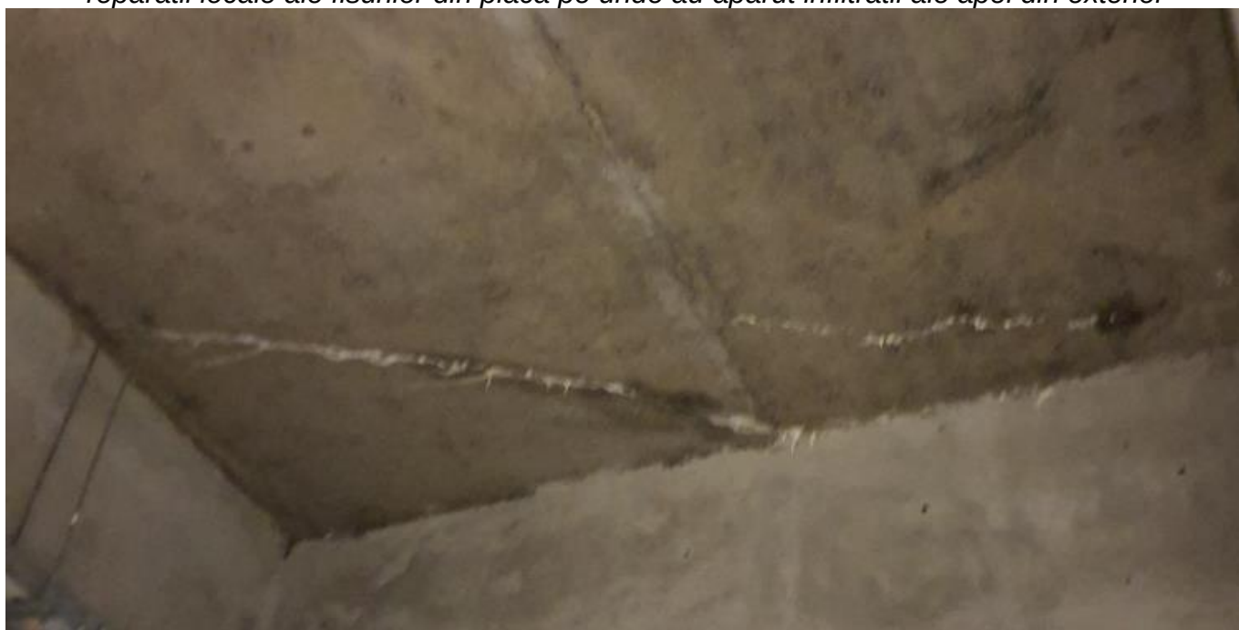
Fig. 11 – Fisuri deschise in placa de peste parcare cu infiltratii ale apei din exterior
