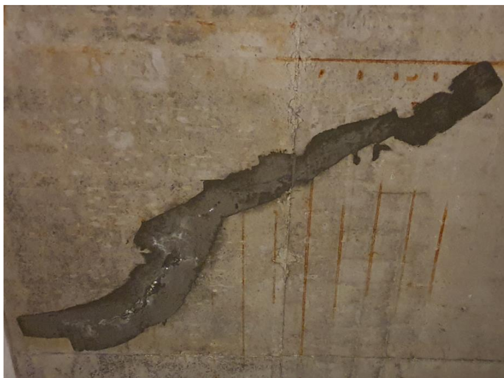
Fig. 10 – Corodarea incipienta a armaturilor de la partea inferioara a placii de peste parcare cu reparatii locale ale fisurilor din placa pe unde au aparut infiltratii ale apei din exterior
