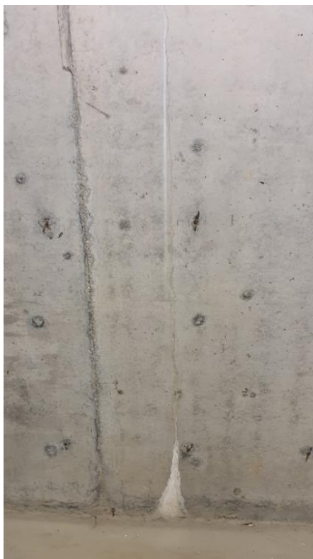
Fig. 5 – Fisura deschisa in peretele structural perimetral cu infiltratii ale apei subterane
