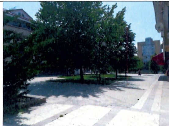
Accesul in perimetrul studiat. Se intalneste acelasi tip de structura rutiere. Betonul este crapat , fisurat , denivelat. Bordurile ce delimiteaza zona verde sunt de asemenea degradate.
