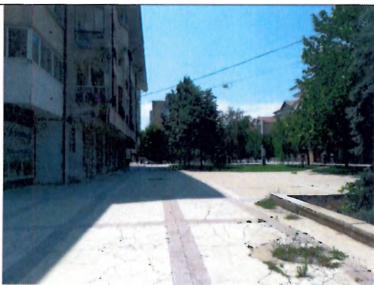
Vedere spre bulevard pe partea dreapta. Se observa betonul de ciment puternic afectat de crapaturi si exfolieri in xona canalizarii.
