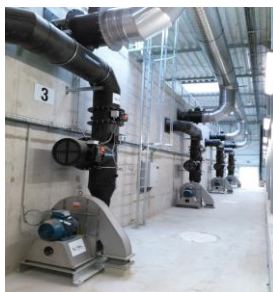
Figură 3-44 SC Sura Mica – exemplu zona tehnică
