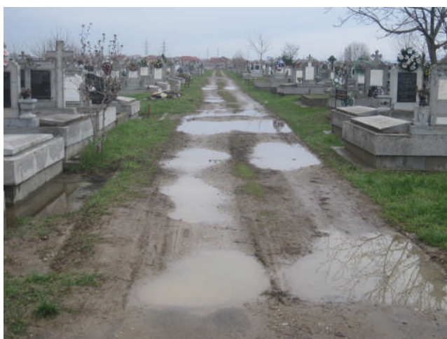
Se observa stagnarea apelor pluviale si starea degradata a fundatiei din balast existente, care a fost innoroita .
