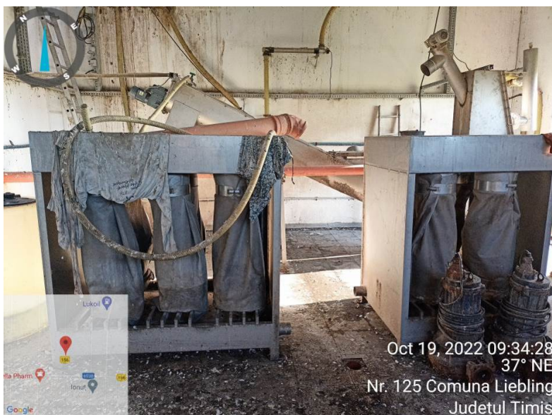
Figura 9 Instalație de deshidratare nămol
