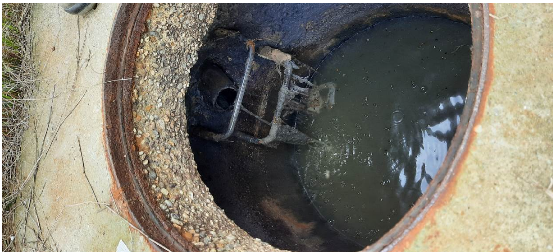
Figura 10 Cămin evacuare apă epurată spre emisar
