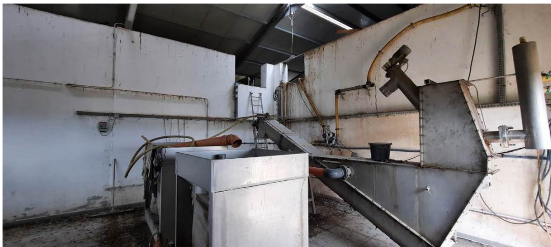
Figura 6 Instalație de pretratare
