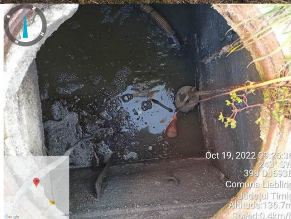
Figura 5 Stație de pompare influent (SP4)
