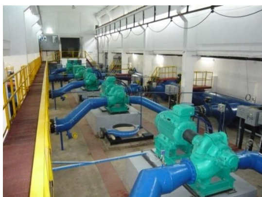
Uzina de apă nr.2- Sala pompelor (foto 2)
