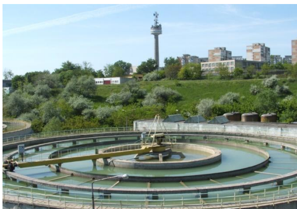
Uzina de apă nr 2-Decantor (foto3)
