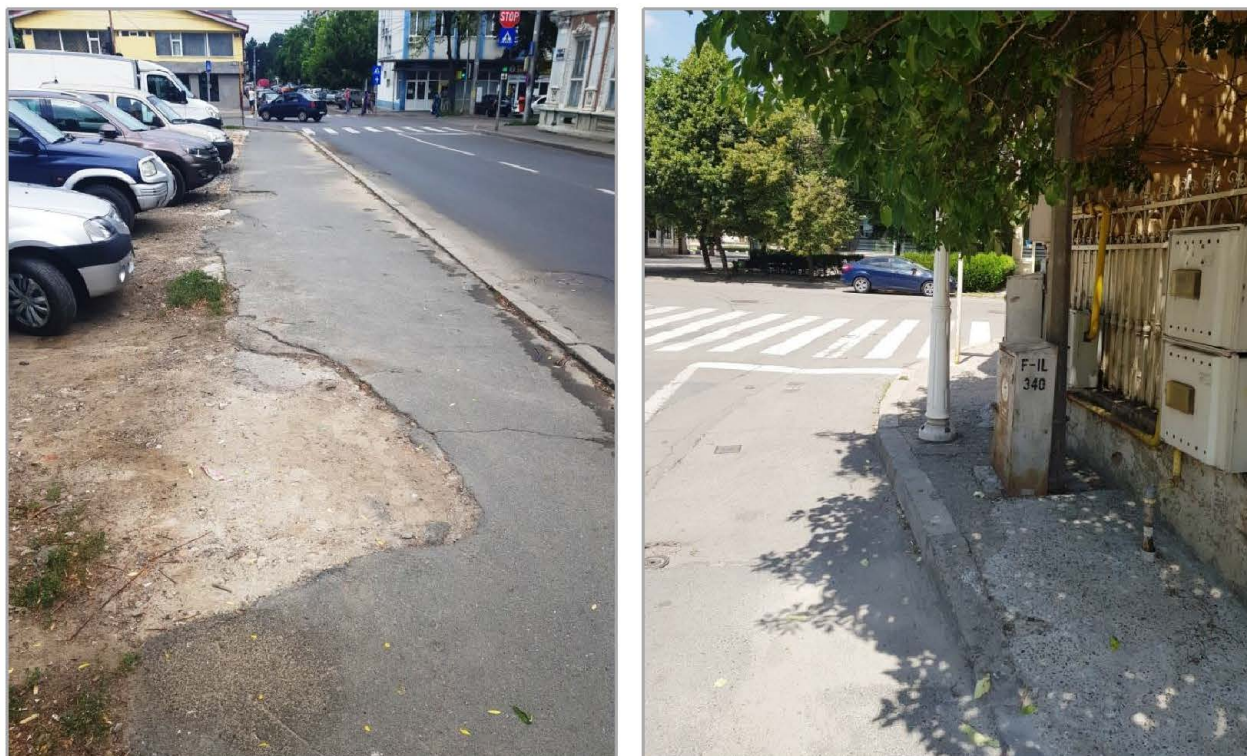
Figura 2.76. Trotuare în stare necorespunzătoare (Exemplificare).
