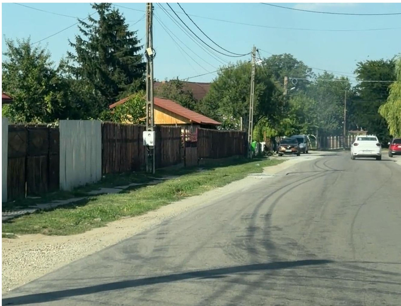
Vedere trotuar existent degradat.
