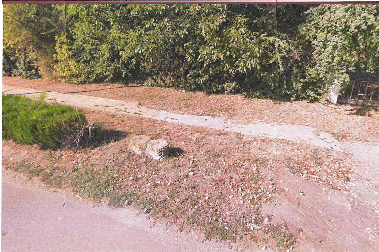
Vedere trotuar existent degradat.
