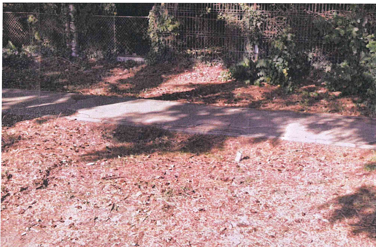
Vedere trotuar existent degradat.
