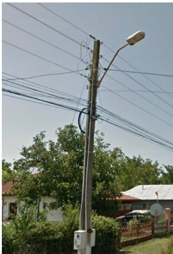
CORP DE ILUMINAT vaporii de sodiu
