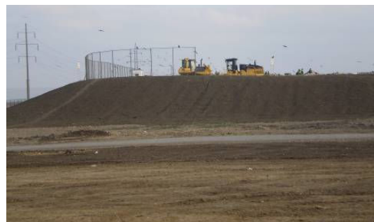
Figura 12. Gard mobil instalat în zona celulei de depozitare
