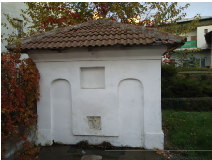
INVELITOARE CERAMICA - OLANE -elemente lipsa; -elemente deteriorate
