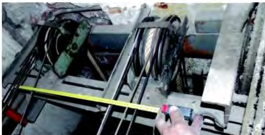
Componente ale lanțului cinematic al cortinei verticale și a contrabarei de decoruri nr 1
