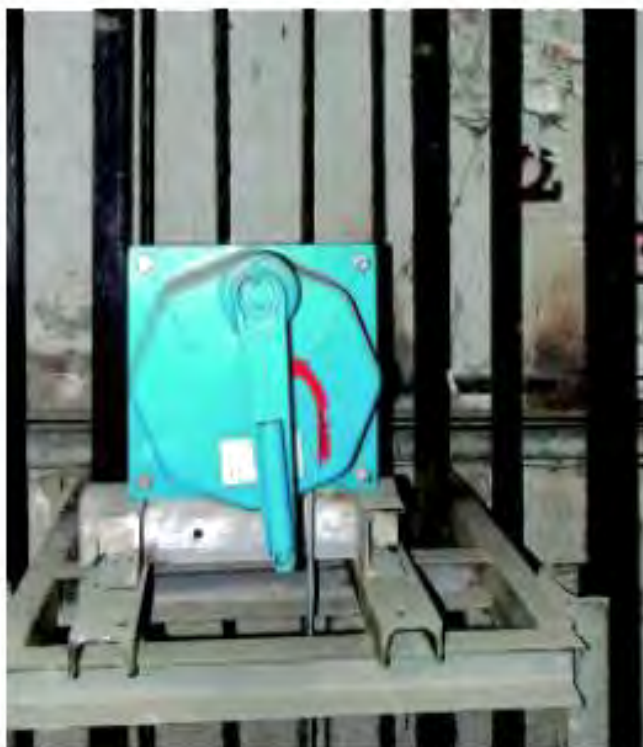
Mecanismul manual de acționare al cortinei verticale- defect
