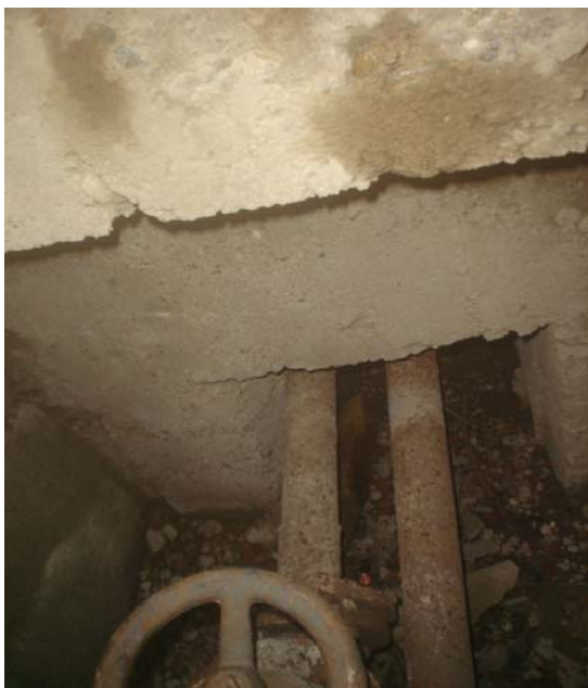
3. Stare conducte in canalul termic: corodate, termoizolatie inexistentă-Colegiul „Elena Cuza”
