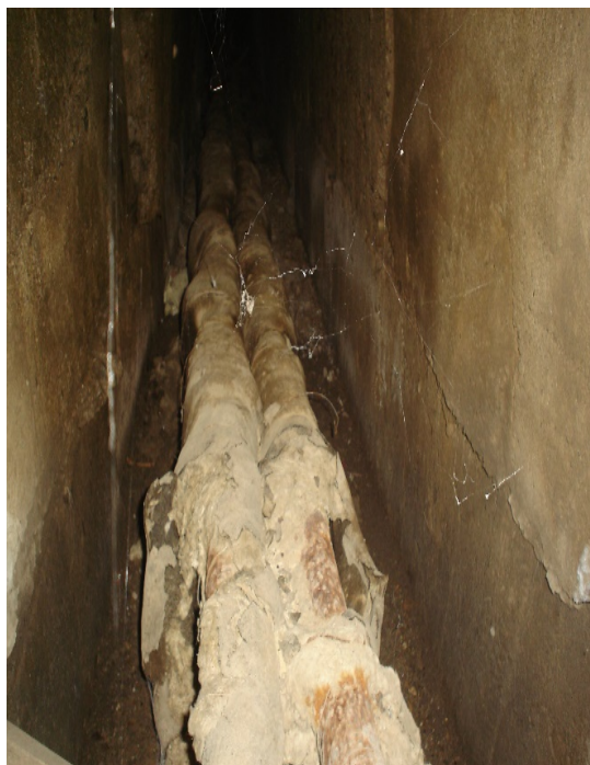
8. Stare conducte in canalul termic: corodate, termoizolatie grav avariata-Colegiul „Elena Cuza”
