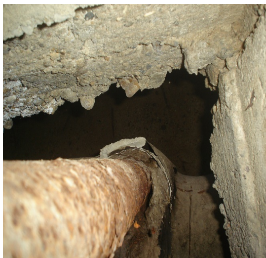
6. Stare conducte in canalul termic: corodate, termoizolatie grav avariata-Colegiul „Elena Cuza”
