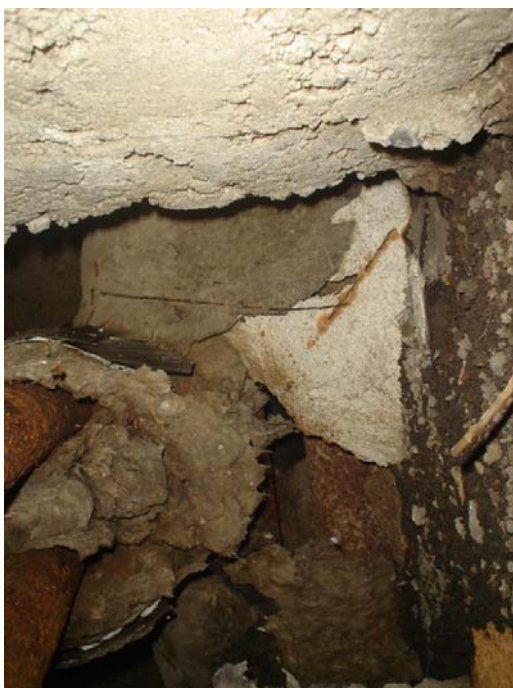
7. Stare conducte in canalul termic: corodate, termoizolatie grav avariata-Colegiul „Elena Cuza”
