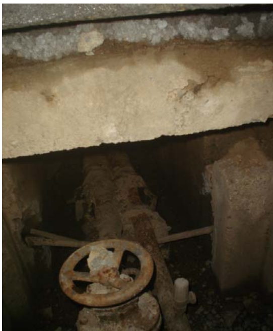
1.Stare conducte in canalul termic: corodate, termoizolatie grav deteriorata-Colegiul „Elena Cuza”
