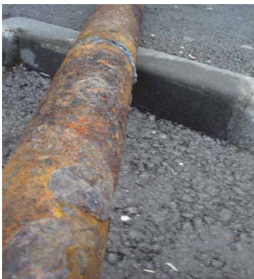
5. Stare conducta: puternic corodată-dupa interventie locala la avarie, la Colegiul „Elena Cuza”.
