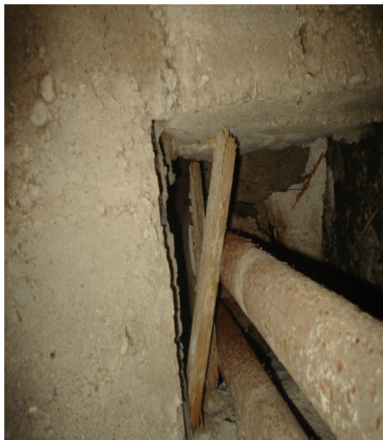
4. Stare conducte in canalul termic: corodate, termoizolatie inexistentă-Colegiul „Elena Cuza
