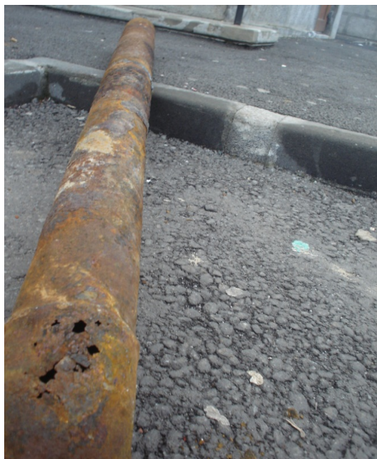
2.Stare conducte: perforata si puternic corodata-dupa interventie locala la avarie, la Colegiul „Elena Cuza”.
