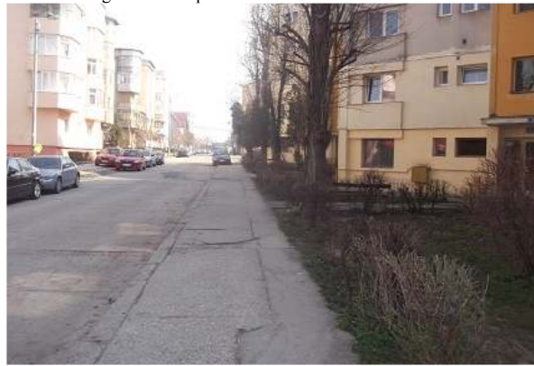
Foto 27.4 Degradari zona pietonală
