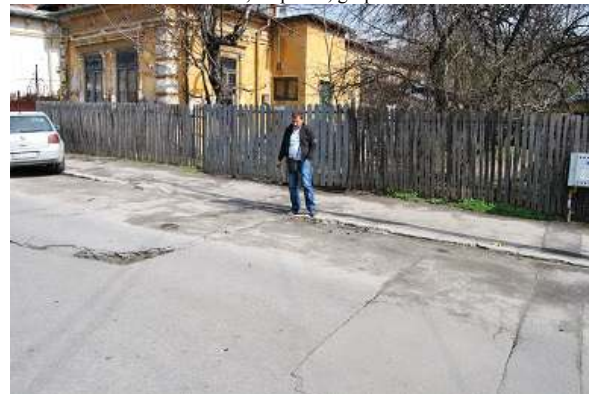
Foto 25.6 Borduri deteriorate, crapaturi, gropi
