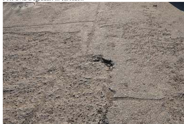
Foto 27.2 Degradări în carosabil
