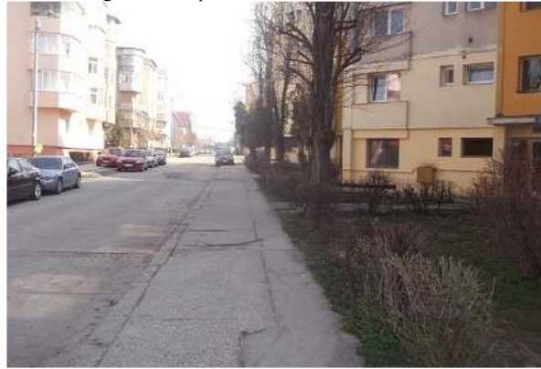
Foto 27.4 Degradari zona pietonală
