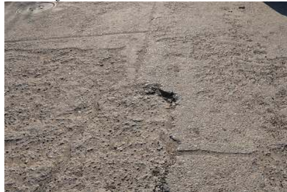
Foto 27.2 Degradări în carosabil
