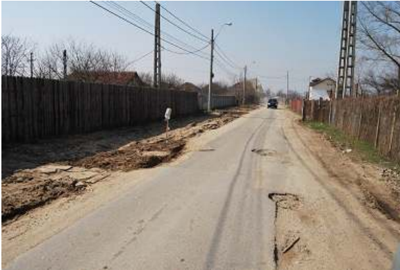
Foto 73.3 Carosabil afectat de lucrări de rețele subterane
