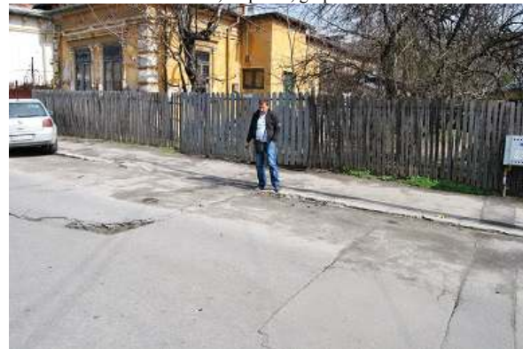
Foto 25.6 Borduri deteriorate, crapaturi, gropi
