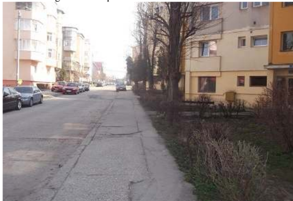
Foto 27.4 Degradari zona pietonală
