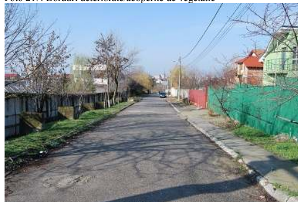
Foto 21.4 Borduri deteriorate/acoperite de vegetatie
