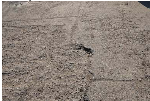
Foto 27.2 Degradări în carosabil
