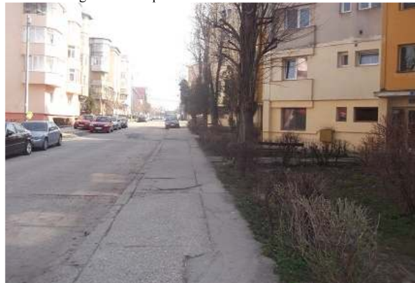
Foto 27.4 Degradari zona pietonală
