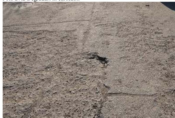
Foto 27.2 Degradări în carosabil
