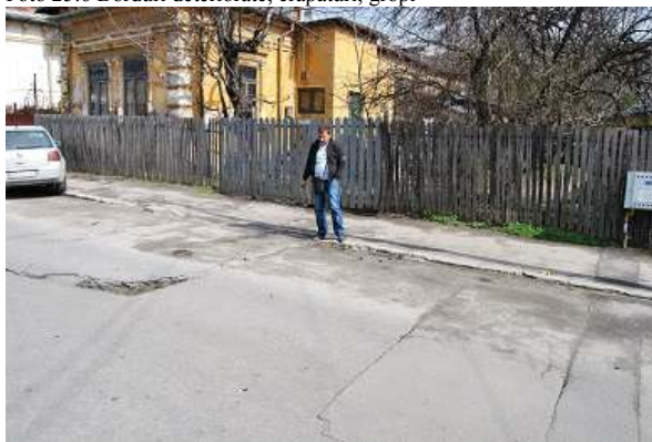
Foto 25.6 Borduri deteriorate, crapaturi, gropi
