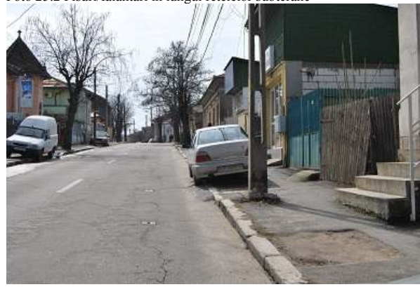
Foto 25.2 Fisuri/faiantari in lungul rețelilor subterane
