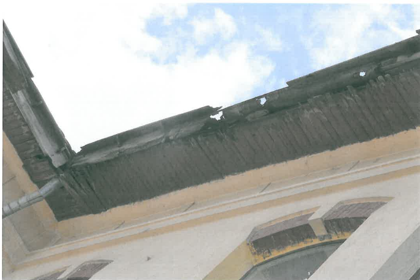
STREAȘINĂ ȘI JGHEABURI DETERIORATE
