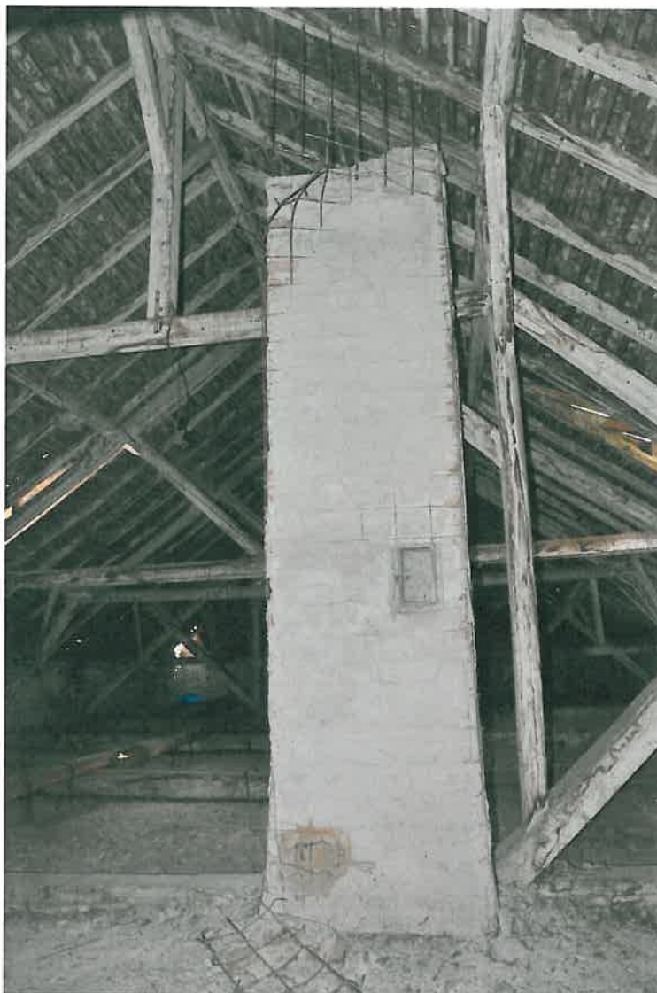
COȘ CONSOLIDAT CU TENCUIALĂ ARMATĂ CU PLASĂ
