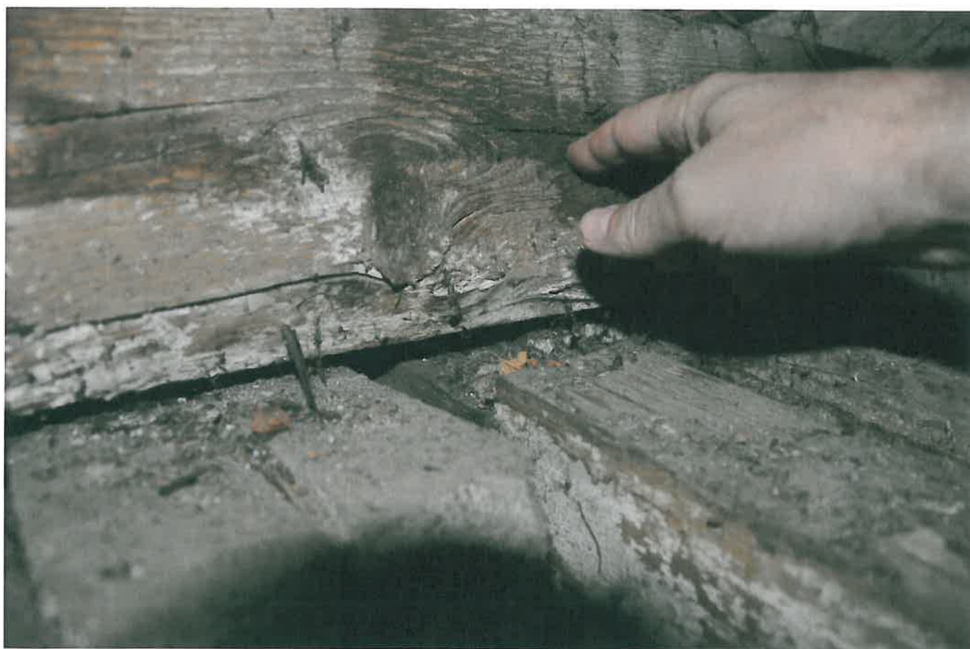
COSOROABĂ DETERIORATĂ ȘI ROTITĂ
