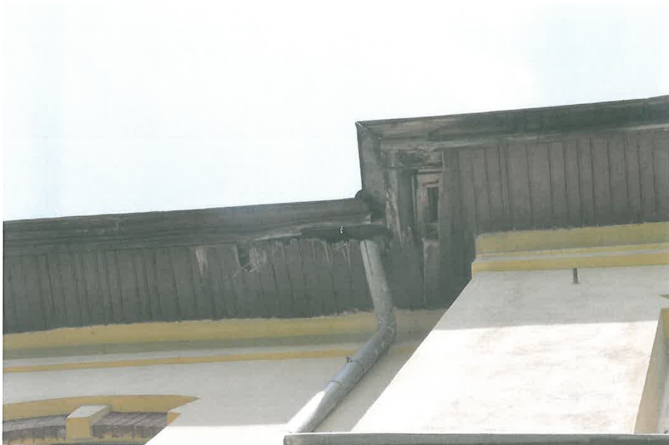
STREAȘINĂ ȘI JGHEABURI DETERIORATE
