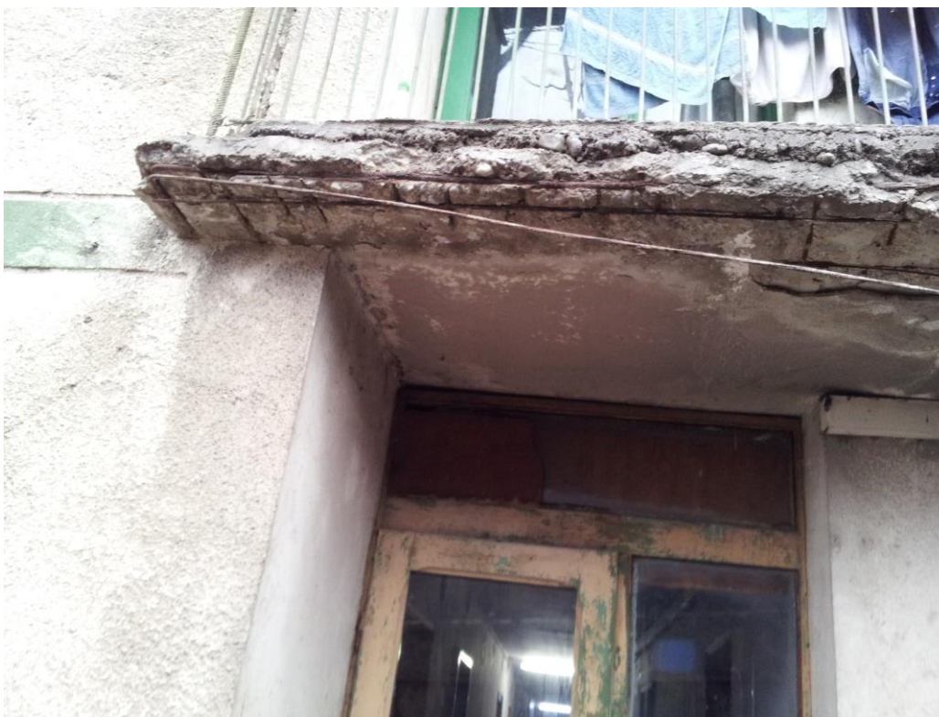
Foto.5 Beton degradat; armaturi descoperite si ruginite – copertina intrare fatada laterala stanga
