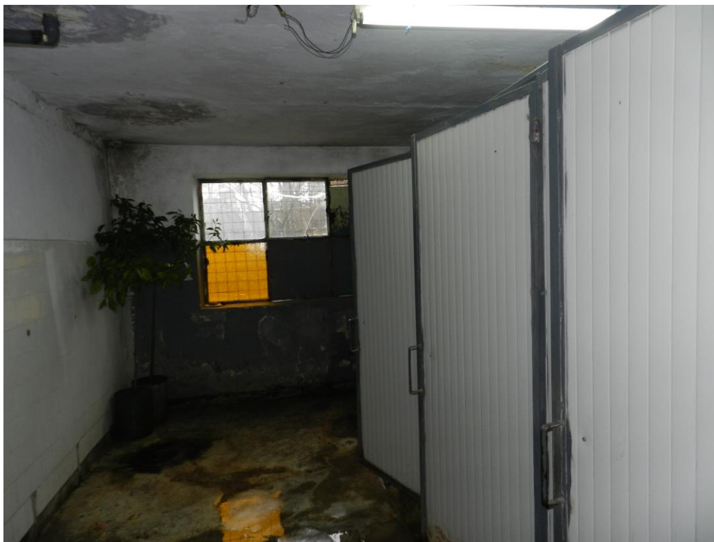
Foto.9 Pardoseli degradate – grupuri sanitare
