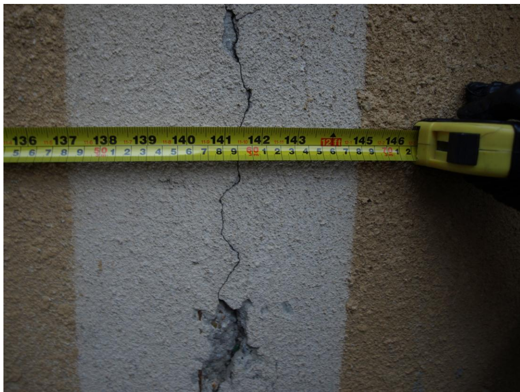
Foto.3 Fisuri in tencuieli – pereti exteriori scara1
