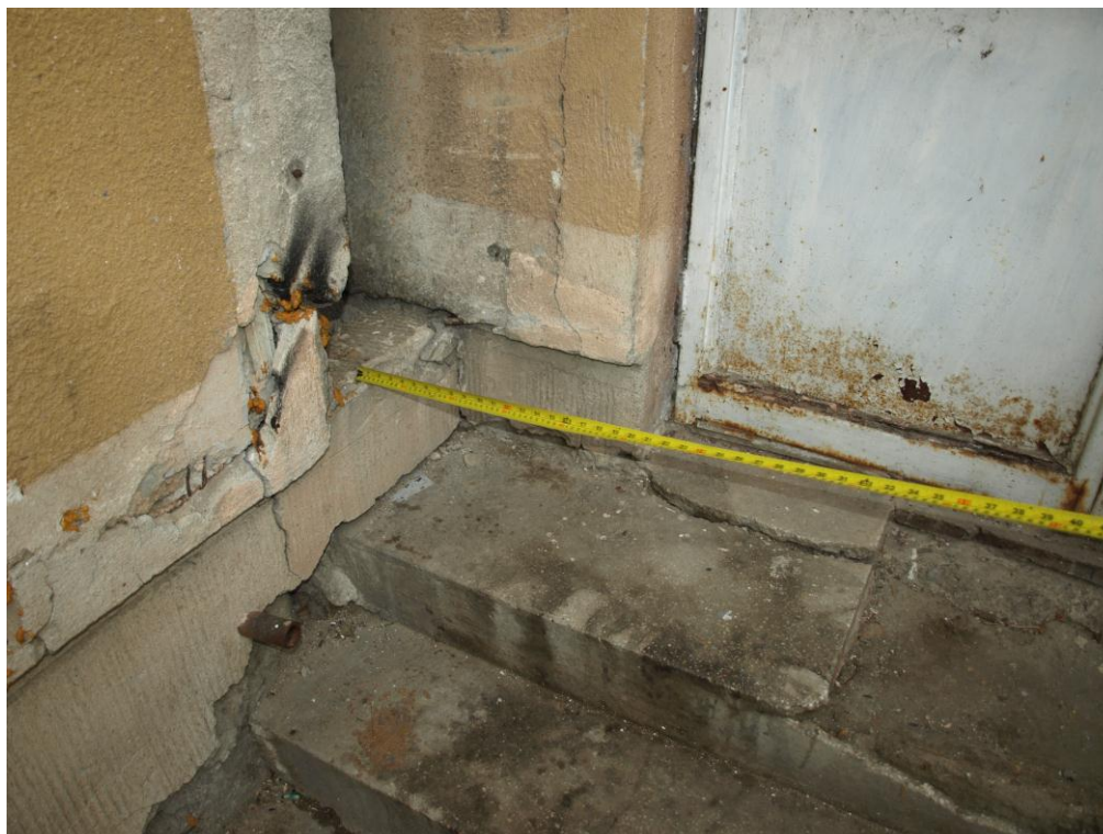
Foto.2 Trepte exterioare degradate – intrare scara secundara
