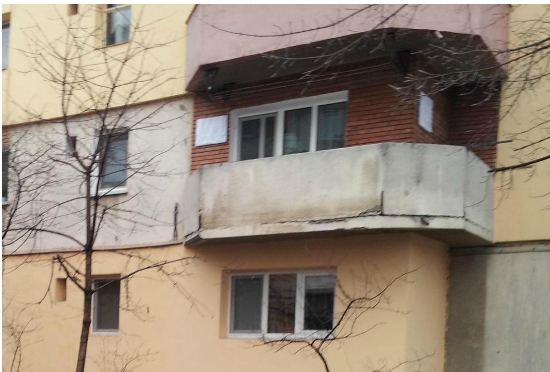
Foto.3 Tencuieli degradate balcon etaj 1 – Bloc127 A
