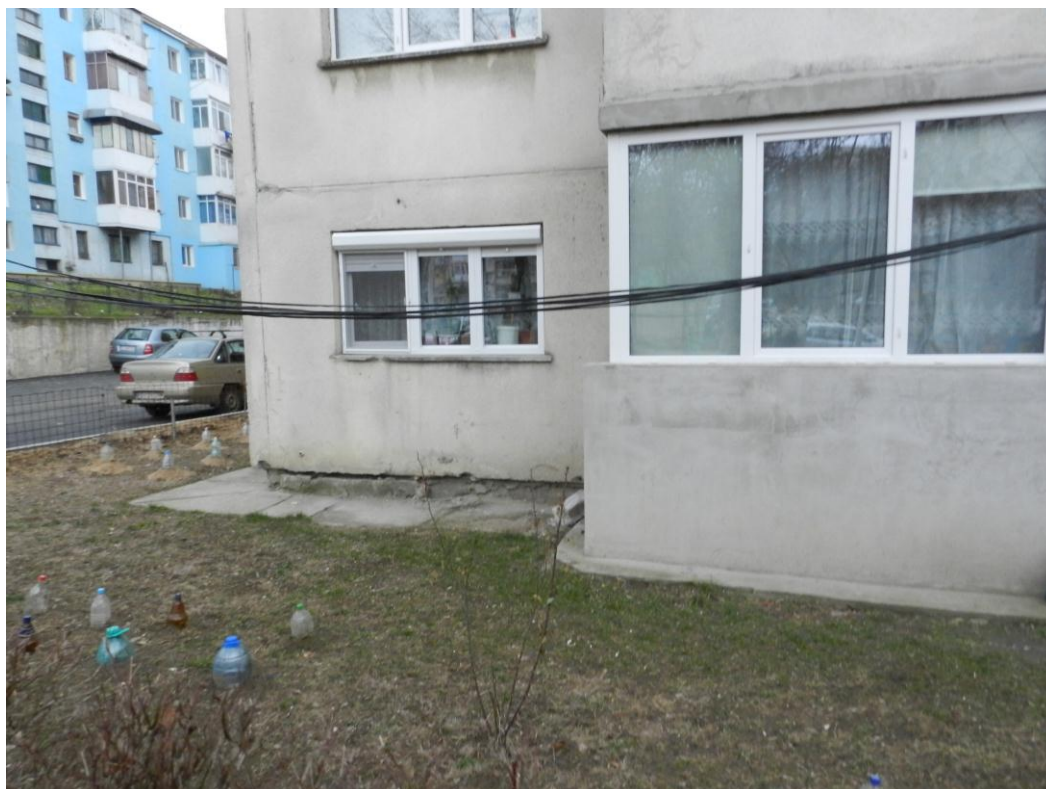
Foto.2 Trotuar tasat si degradat
