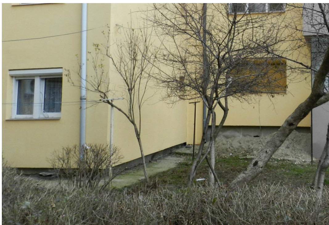
Foto.2 Soclu si trotuar degradat
