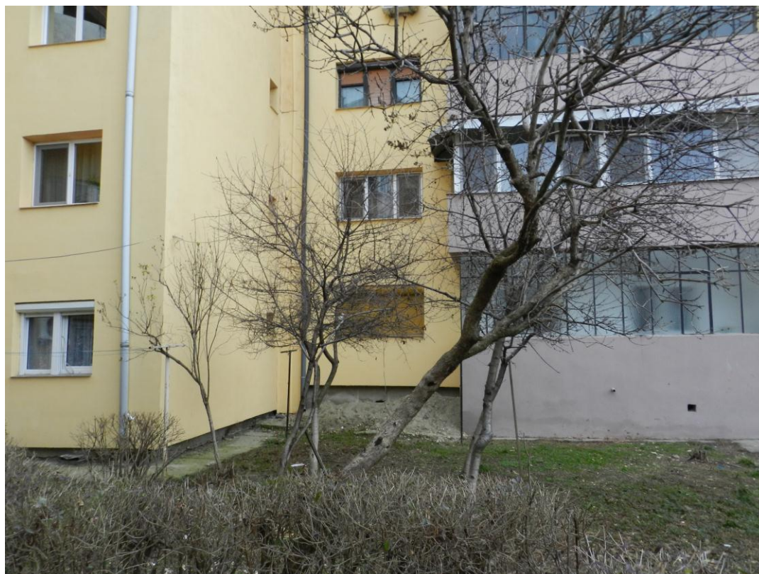
Foto.2 Soclu degradat; trotuar lipsa
