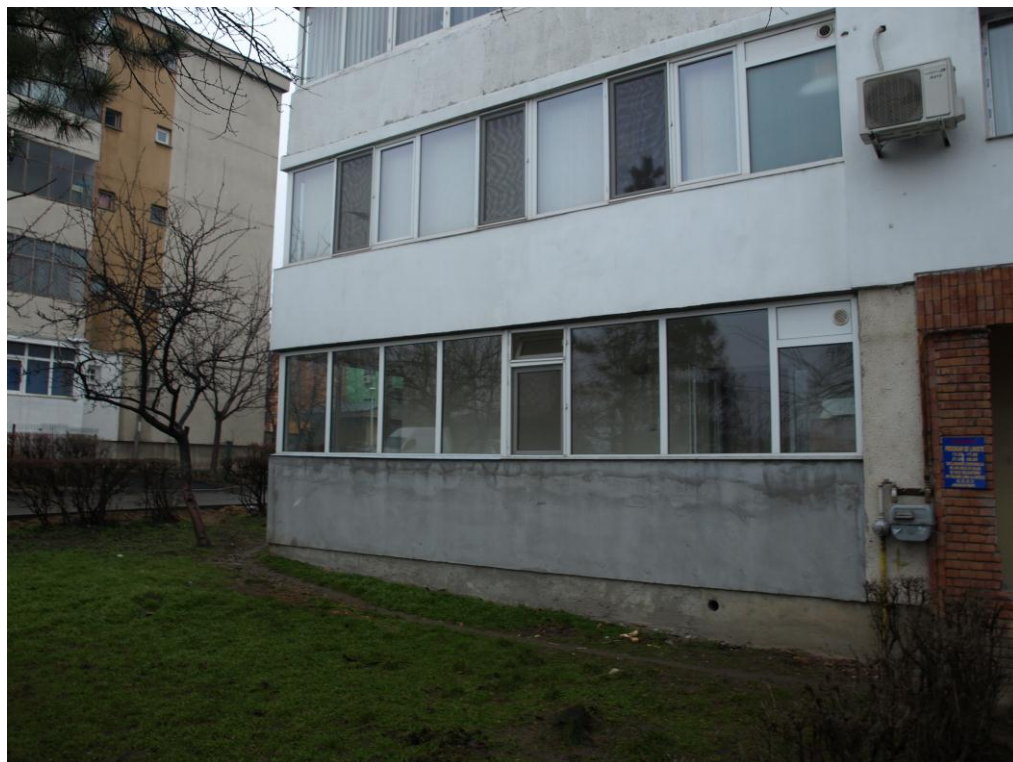
Foto.4 Tencuieli degradate la soclu; trotuar lipsa
