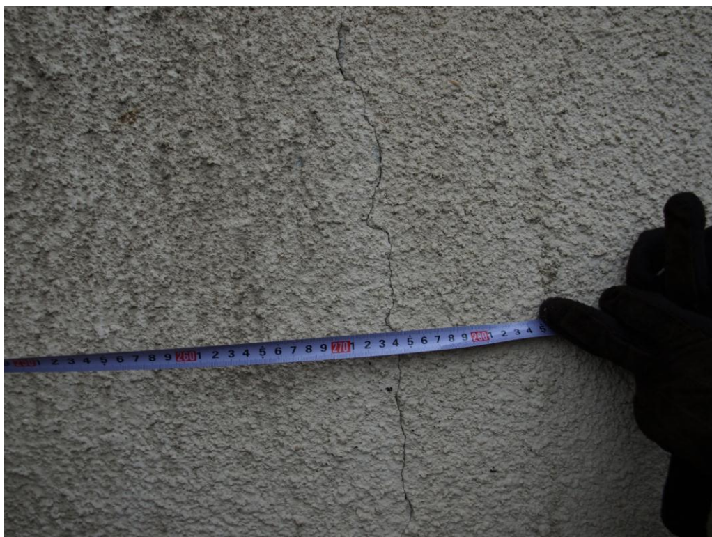
Foto.3 Fisuri in tencuiala – pereti parter
