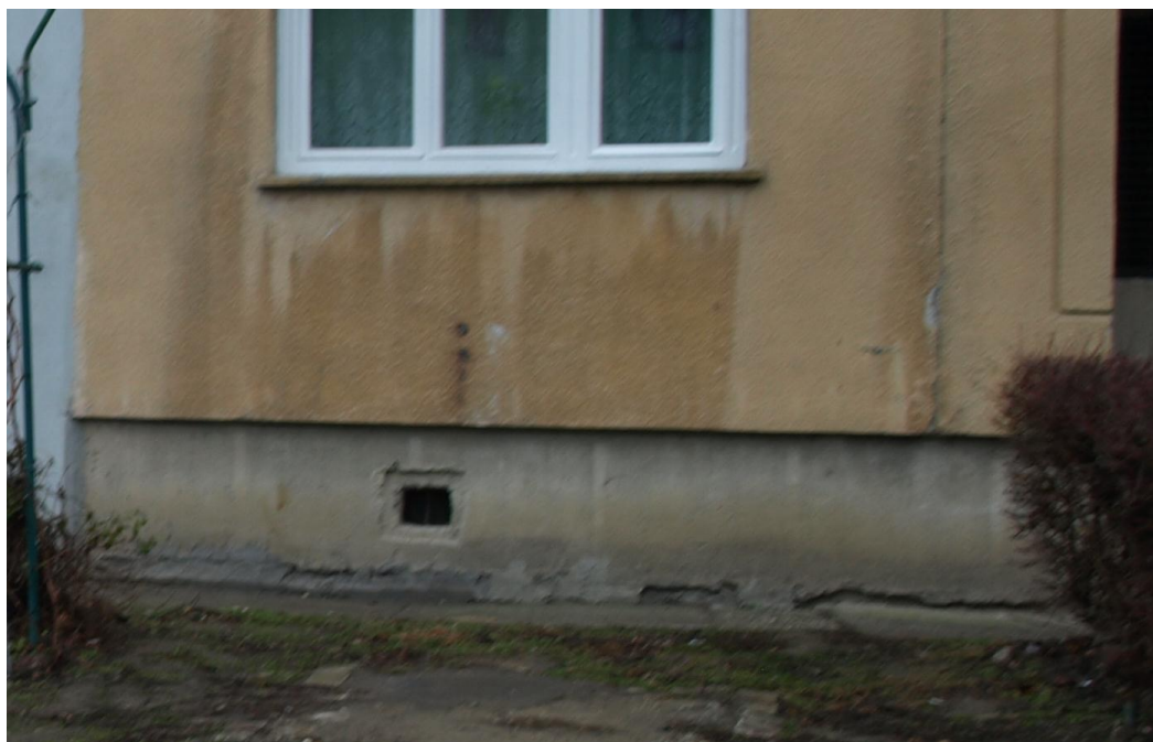
Foto.2 Fisuri mici in peretii exteriori; trotuar tasat si degradat
