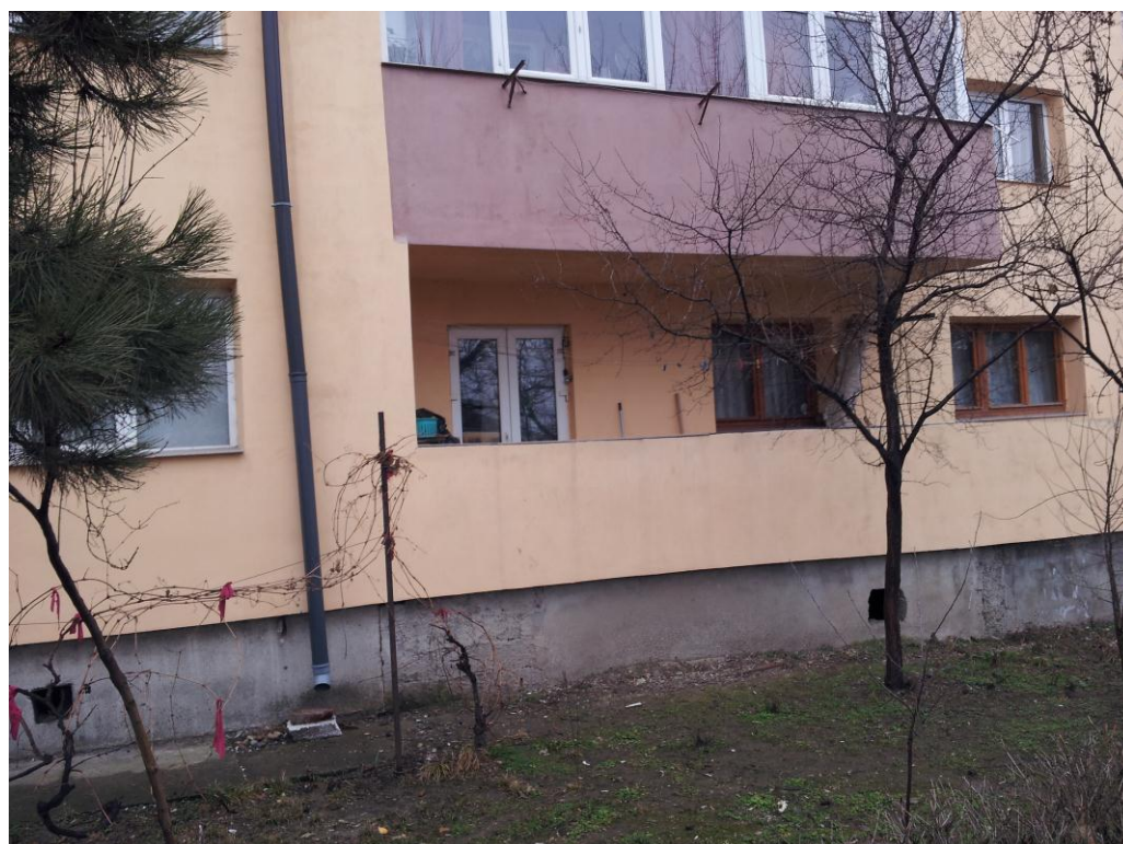
Foto.2 Tencuieli cazute la soclu; trotuar tasat si degradat
