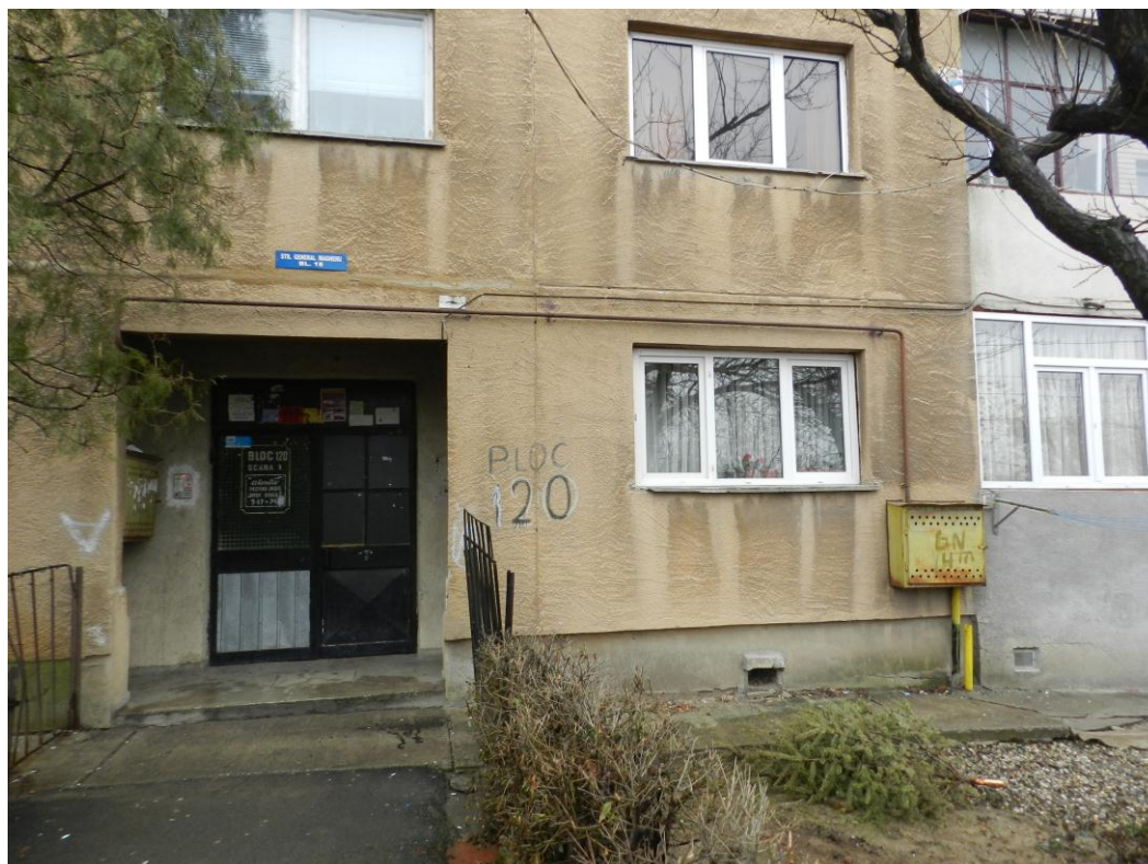
Foto.3 Trotuar degradat – fatada principală
