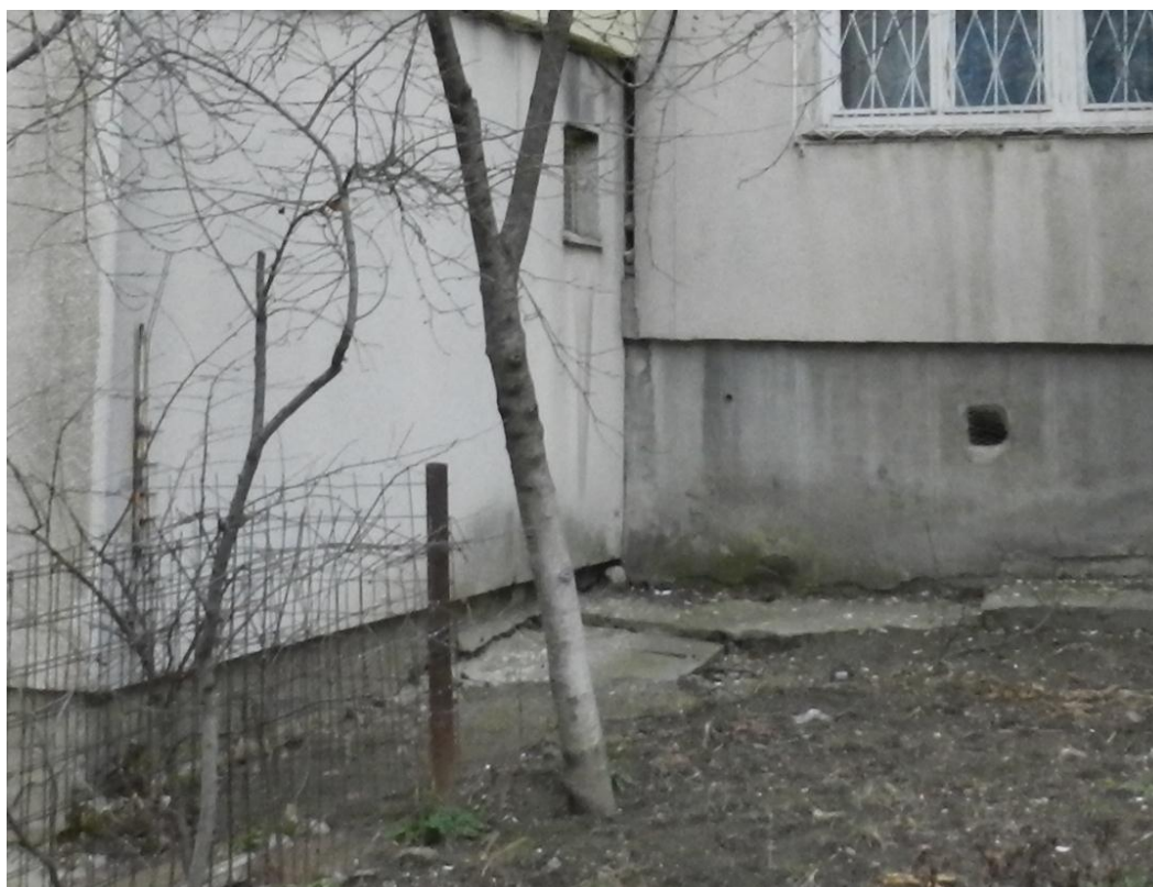
Foto.4 Trotuar degradat – fatada laterală dreapta
