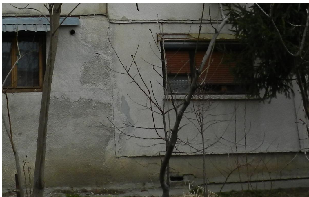
Foto.4 Microfisuri in tencuieli pereti parter, tencuieli cazute la soclu, trotuare degradate
