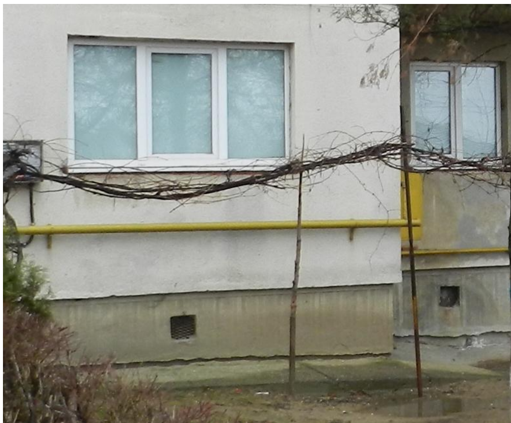
Foto.2 Fisuri mici la soclu. Trotuar tasat si degradat
