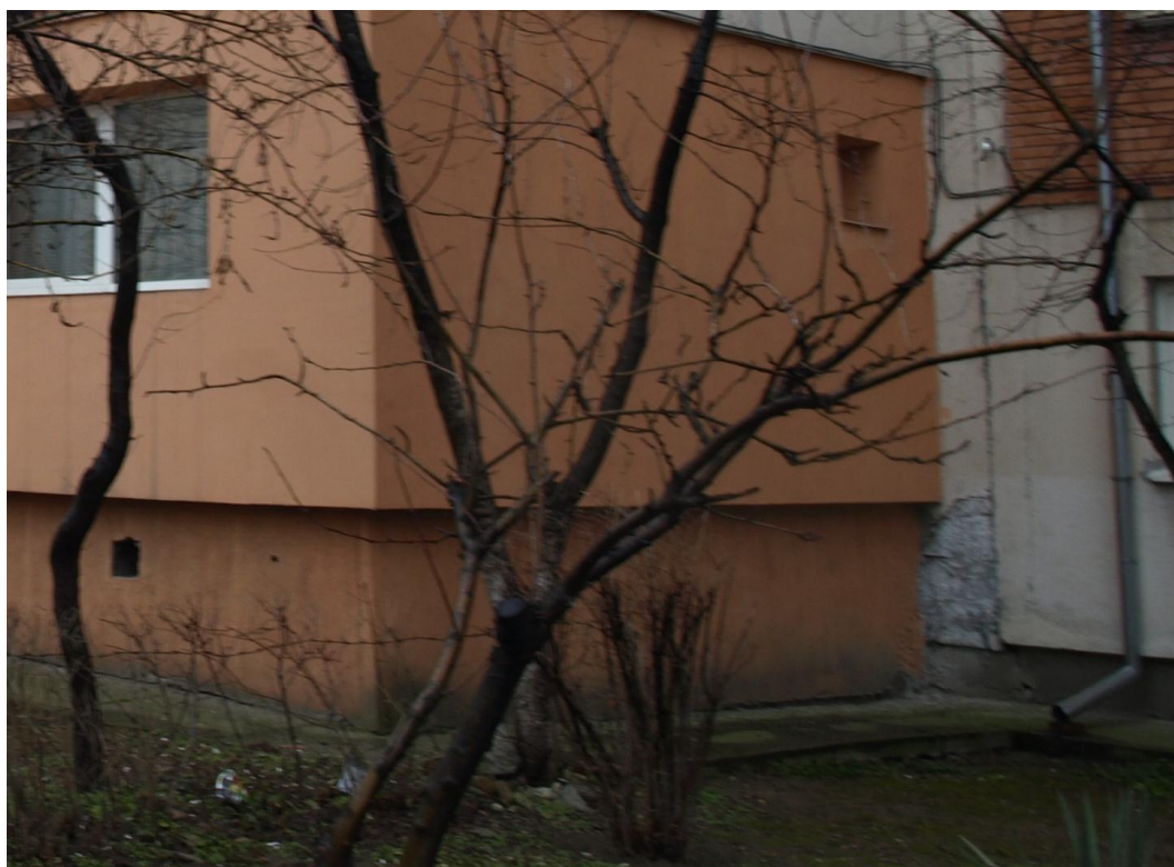
Foto.2 Trotuar tasat si degradat
