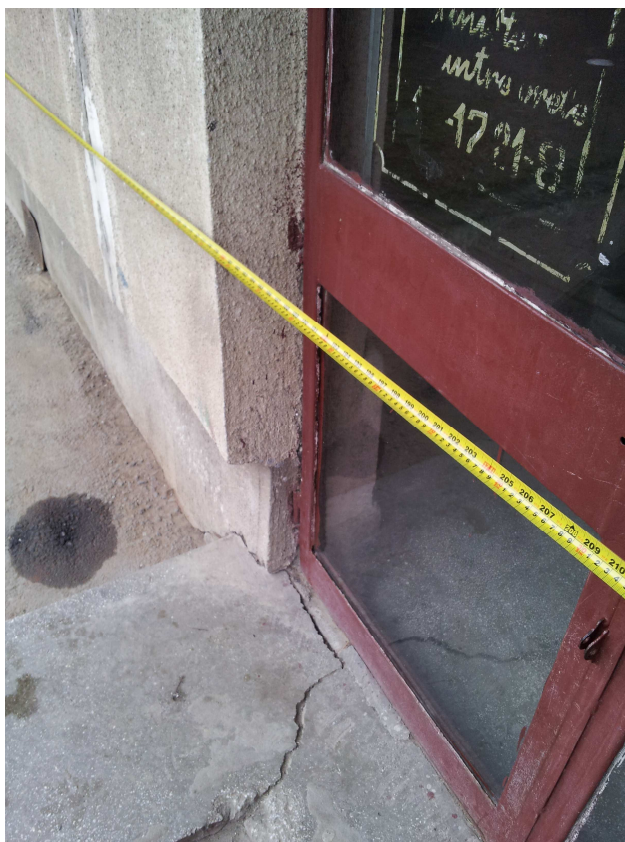
Foto.3 Fisuri si crapaturi in podest scara intrare
