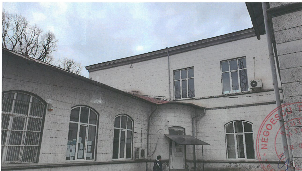
Figura 6: Fisuri verticale in pereteii structurali ai fatadei posterioare, fisuri aflate in vecinatatea sistemului de prindere a tirantilor, degradari ale invelitorii;
