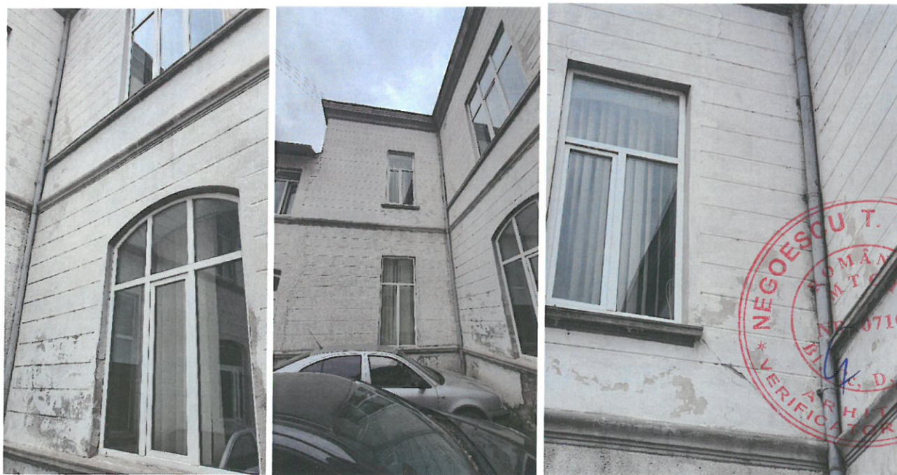
Figura 7: Deteriorarea fatadelor, fisuri verticale la saltul de rigiditate intre cele doua zone realizate in etape diferite;
