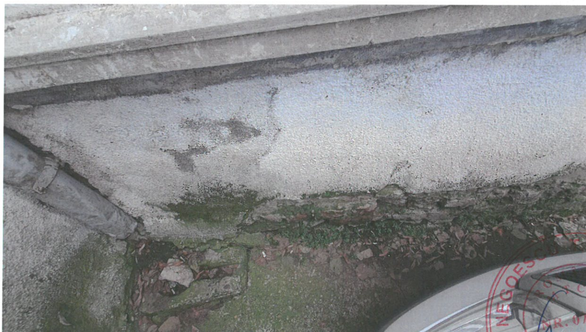
Figura 9: Infiltratii la nivelul trotuarului si degradari ale tencuielii. Infiltratii de lunga durata cu cresterea de muschi pe suprafata tencuielilor.
