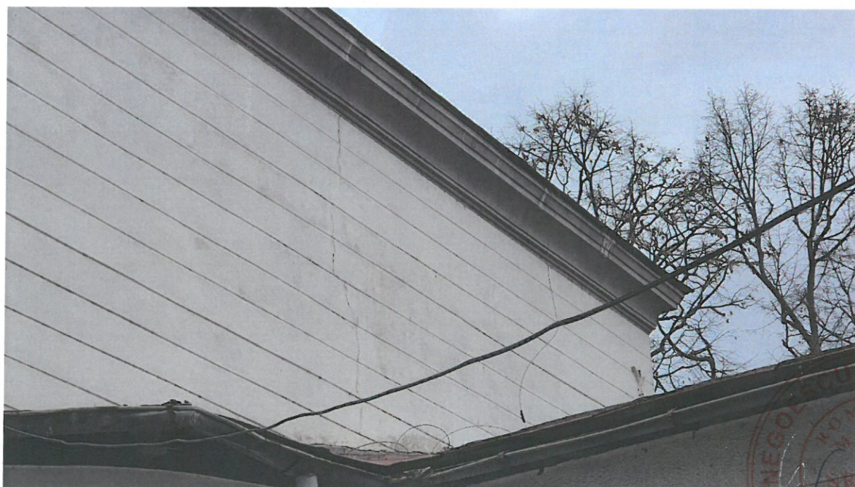
Figura 5: Fisuri verticale in peretii fatadelor din variatii de temperatura.
