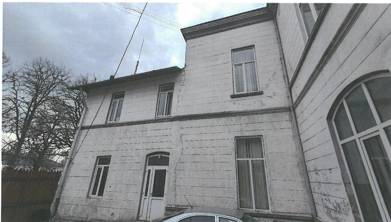
Figura 2: Fisuri verticale in zona de rost intre cele doua constructii realizate in etape diferite;
