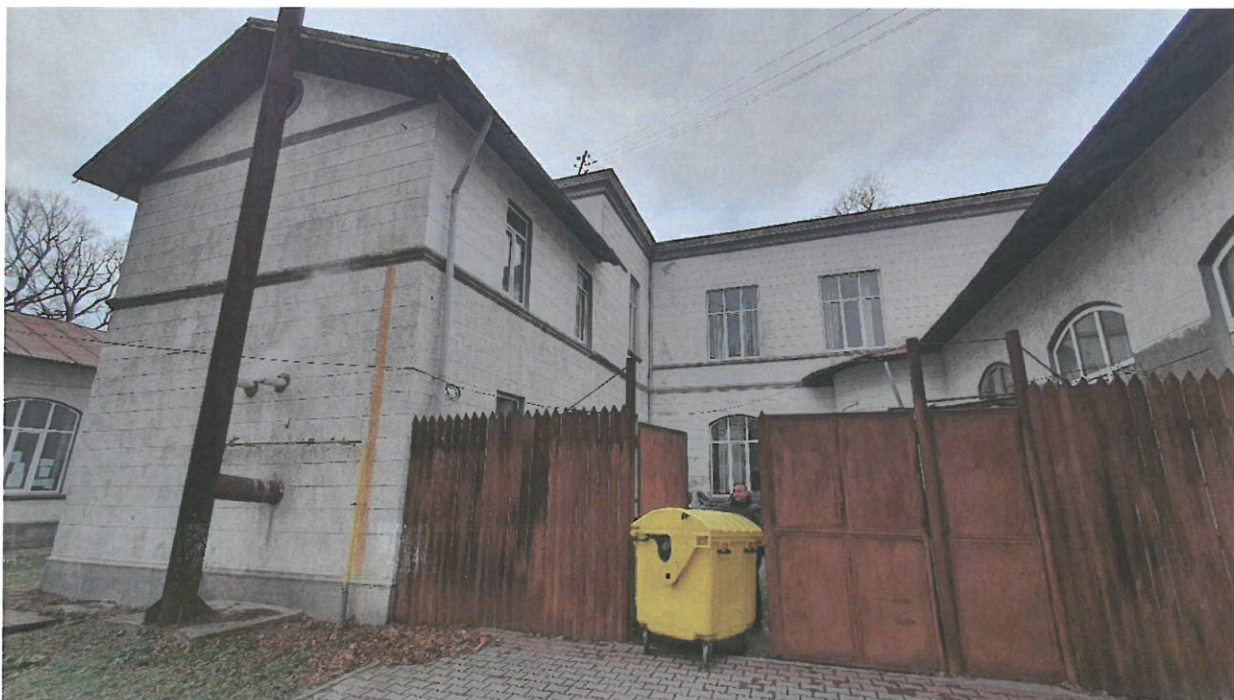
Figura 12: Trotuar perimetral incomplete in jurul corpului realizat ulterior.
