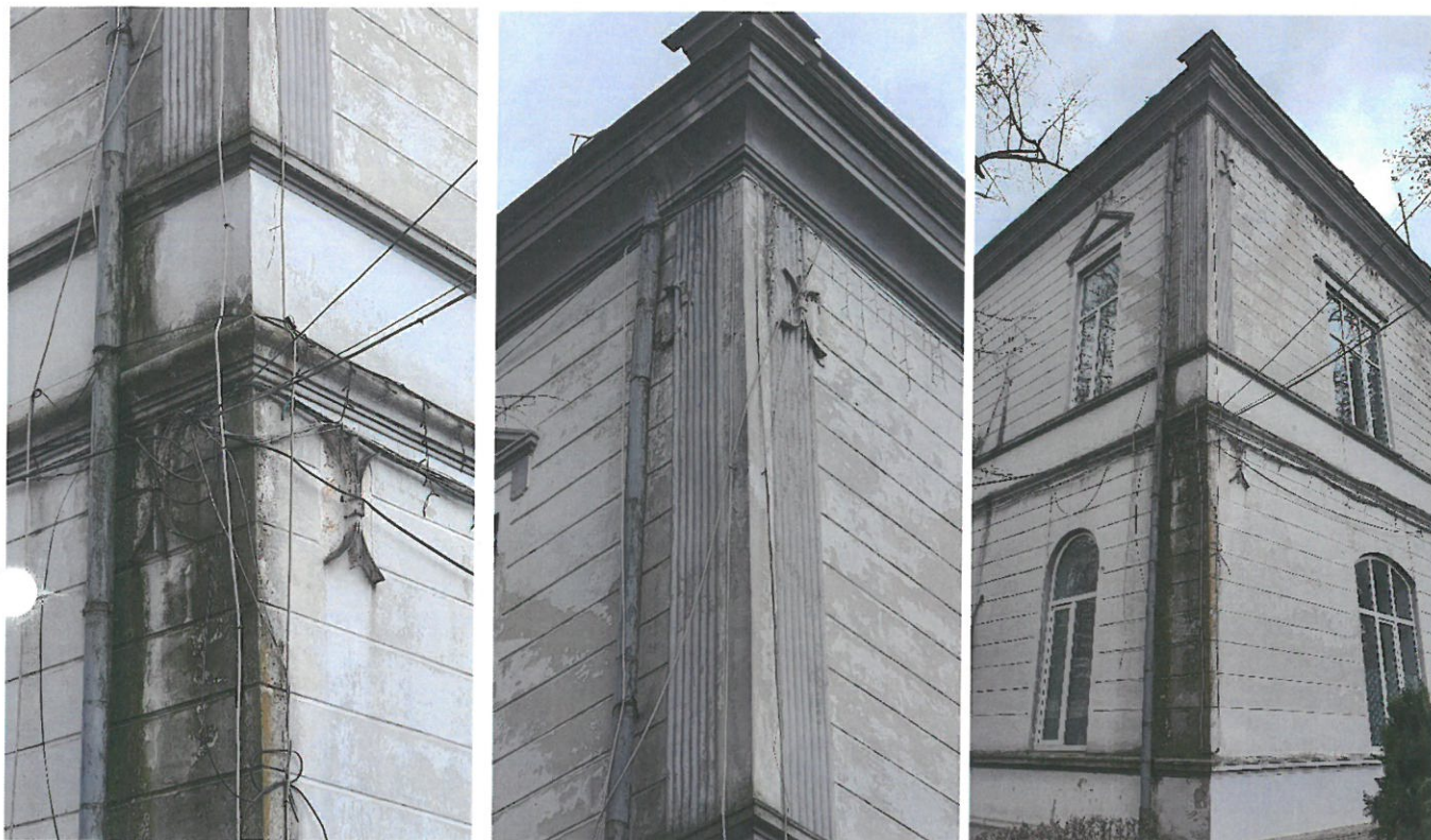
Figura 6: : Deteriorarea fațadelor din cauza infiltrațiilor apelor meteorice, burlane nefuncționale; sistemul de prindere al tiranților orizontali pe doua direcții ortogonale realizați din platbanda.
