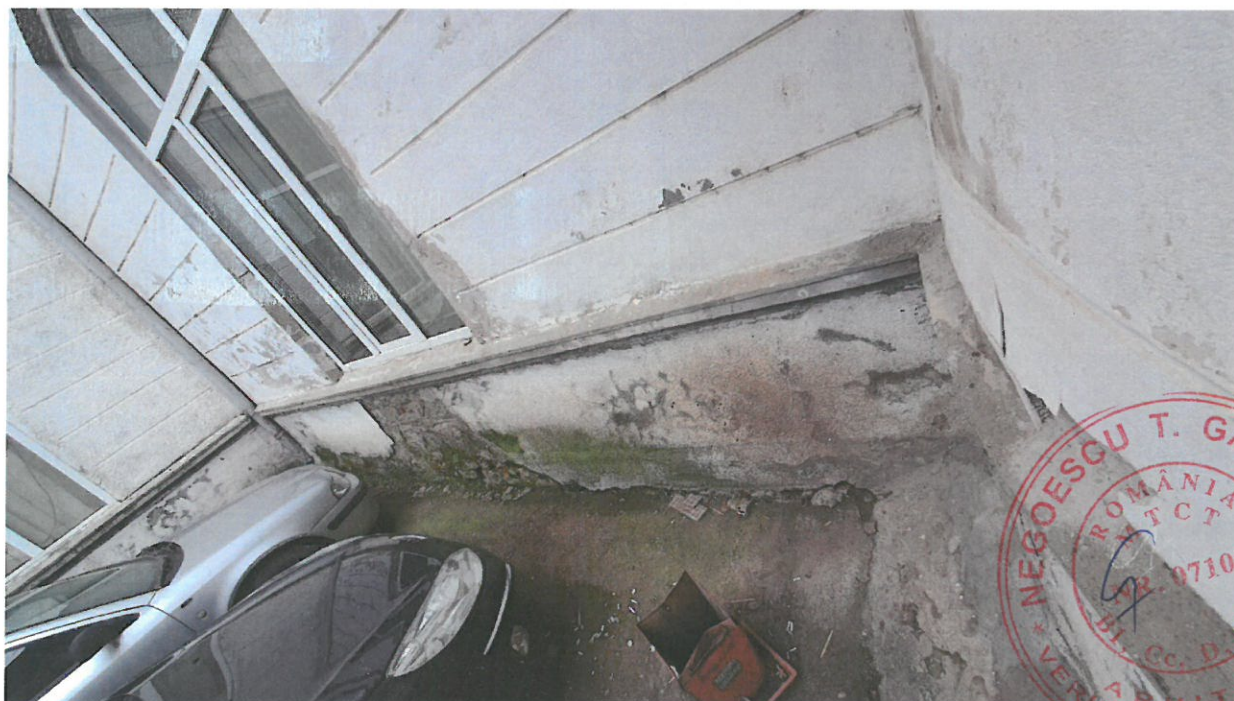
Figura 157-Degradarea tebcuiei și a a cărămizii din cauza infiltrațiilor masive și de lungă durată.
