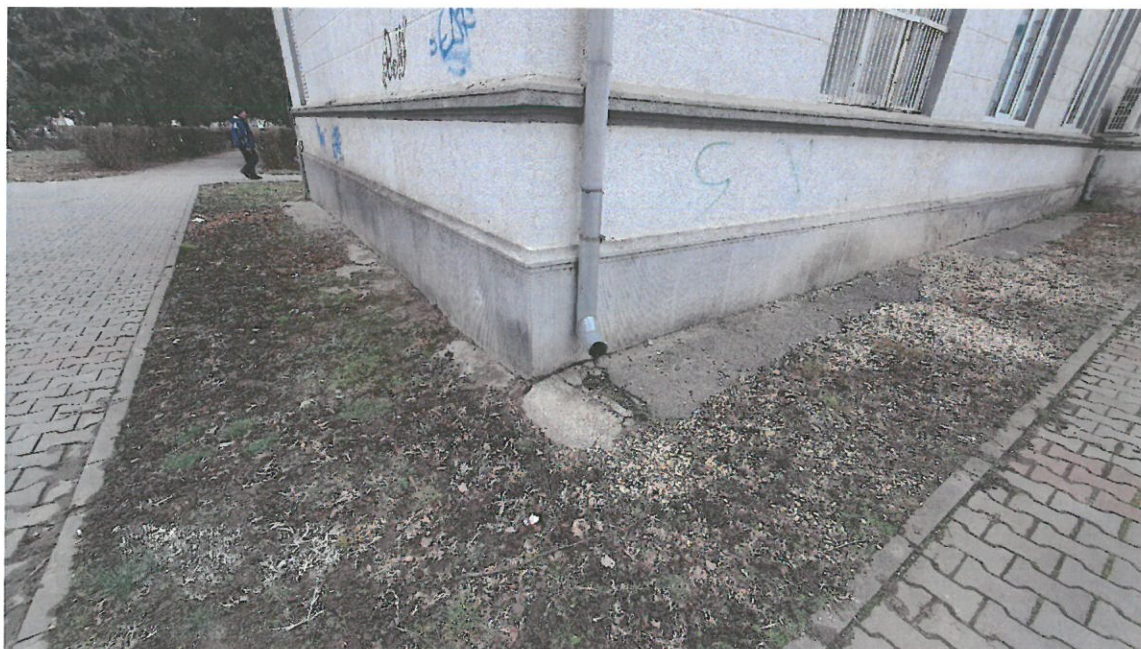
Figura 14: Infiltrații din ape meteorice cu deteriorarea soclului și a trotuarului perimetral; mod de scurgere a apelor necorespunzător ce conduce la tasări, degradări ale trotuarelor și umiditatea excesivă a terenului de fundare.
