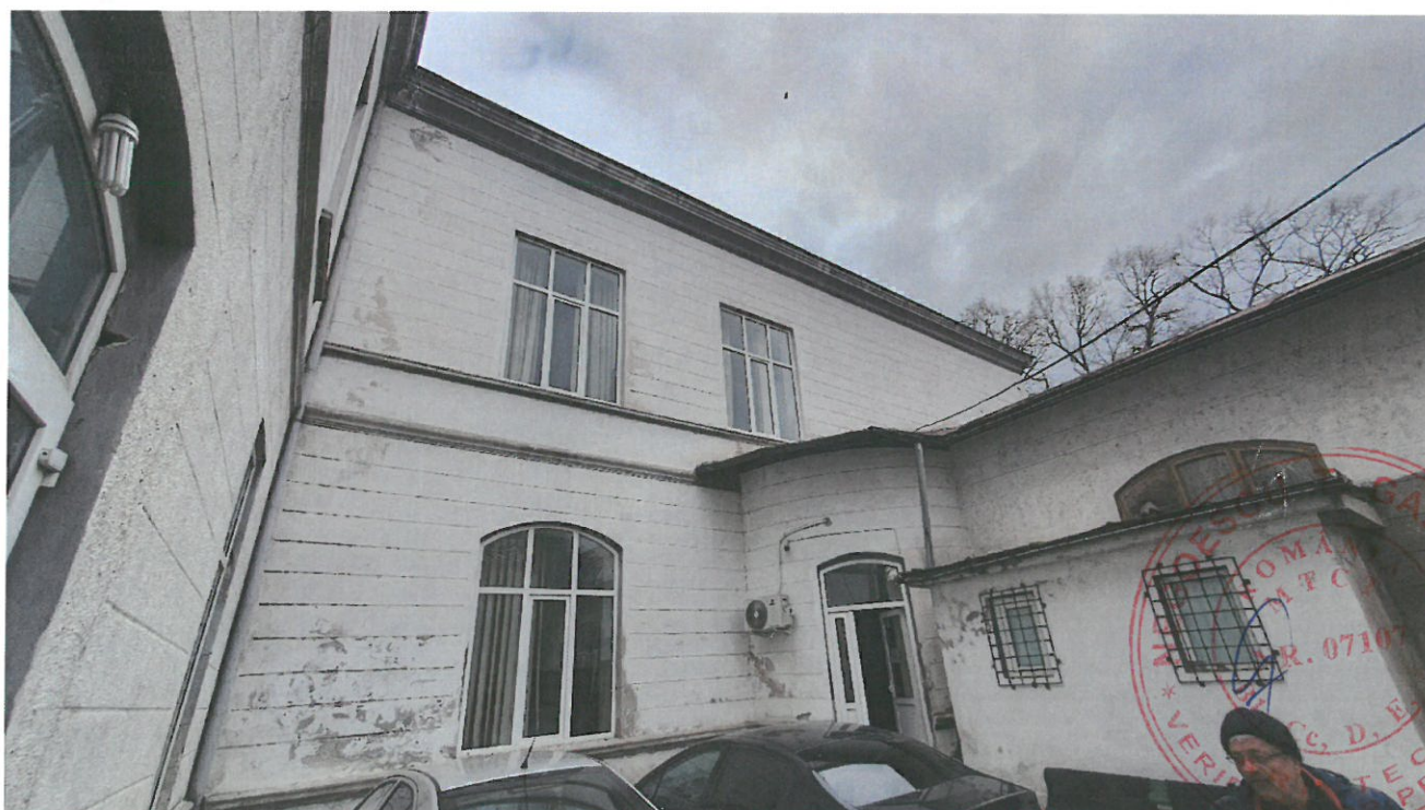
Figura 3: Fisuri din variatii de temperatura la nivelul corniselor, degradari ale tencuielilor;
