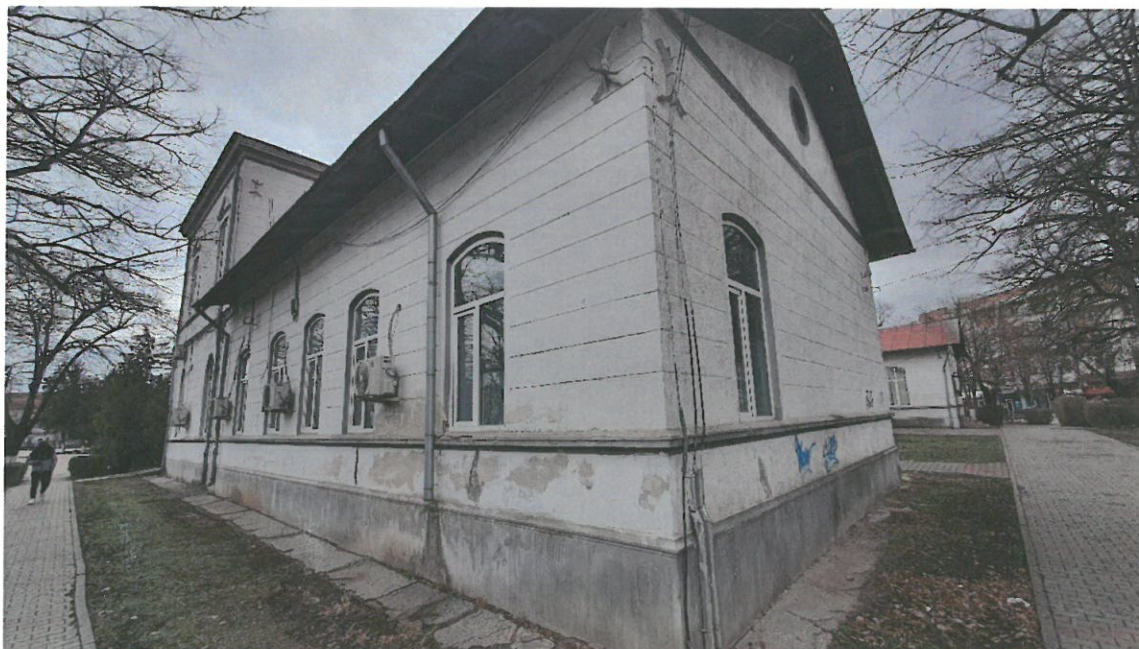
Figura 104: Finisaje ale fațadei puternic degradate, tasări de ordinul centimetrelor a trotuarelor.
