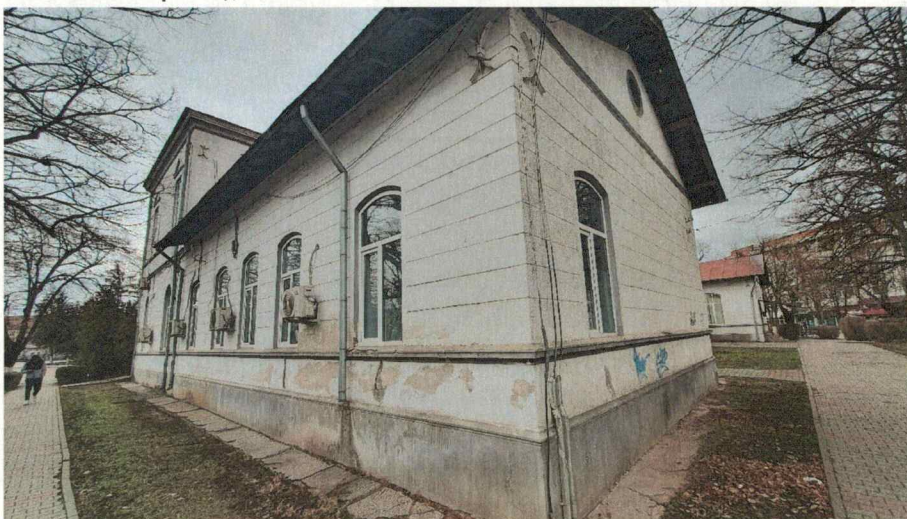
Figura 1: Fisuri în pereții fațadelor, degradări ale trotuarelor perimetrale, fisuri verticale la colțurile clădirii;
