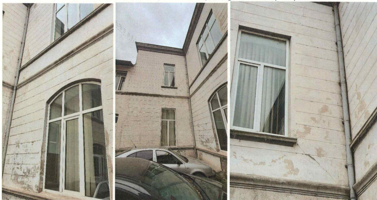
Figura 7: Deteriorarea fatadelor, fisuri verticale la saltul de rigiditate între cele două zone realizate în etape diferite;
