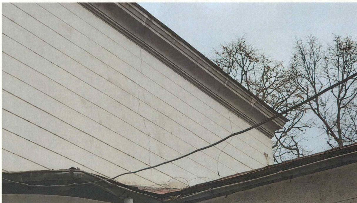
Figura 5: Fisuri verticale in peretii fatadelor din variatii de temperatură;
