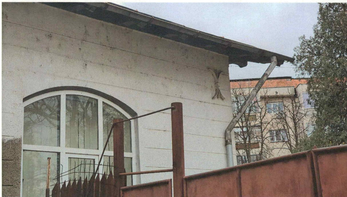
Figura 4: Fisuri la cheia boltii ce constituie buiandrug pentru fereastra;
