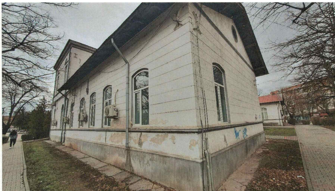
Figura 102: Finisaje ale fațadei puternic degradate, tasări de ordinul centimetrelor a trotuarelor.
