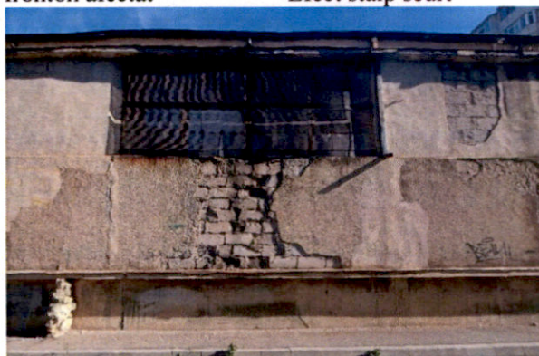
Pereți autoportanți avariați
