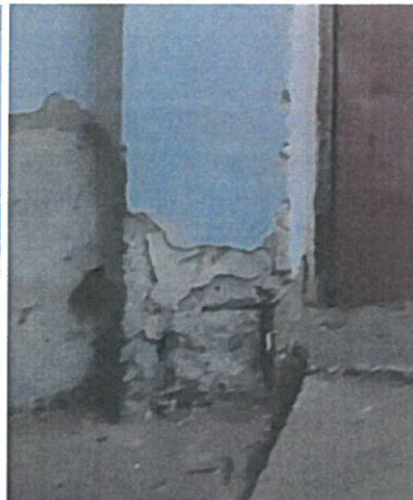
Stâlp de fronton afectat
