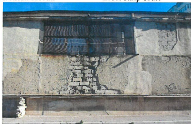
Pereți autoportanți avariați
