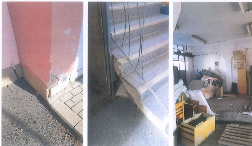
Foto nr. 3, Foto nr. 4 si Foto nr. 5 – Degradări ale elementelor nestructurale
