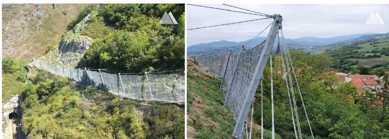
Figura 13 – Bariere de protecție, împotriva căderilor de pietre, utilizate cu caracter temporar
