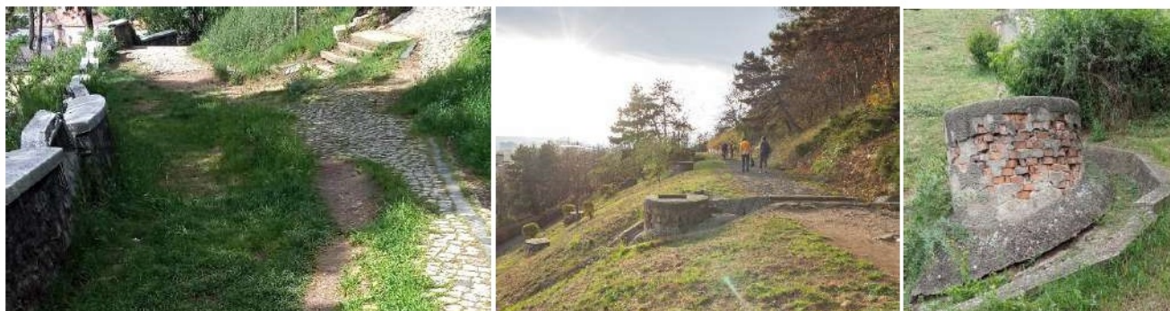
Figura 2 – Situația existentă – elemente degradate
